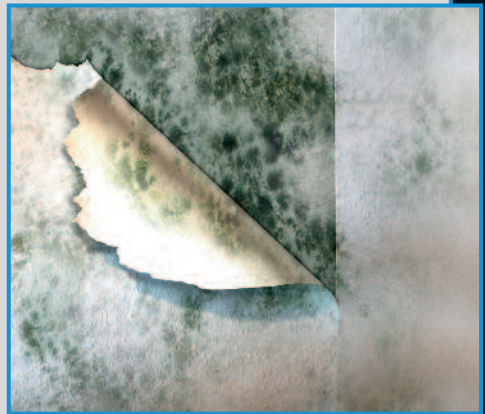
Typischer Schimmelbefall im Wohnbereich.
